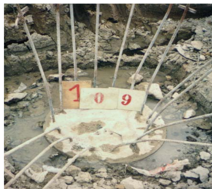
รูปที่ 8 น้ำซึมขึ้นตามแนวเหล็กเสริมยื่นและตามแนวเก่าของท่อ Tremie (ณรงค์, 2543)
