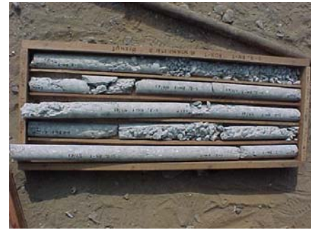
รูปที่ 7 สภาพคอนกรีตที่เจาะขึ้นมาจากหัวเสาเข็มเจาะที่คอนกรีตเกิดมีการเข้มน้ำ
