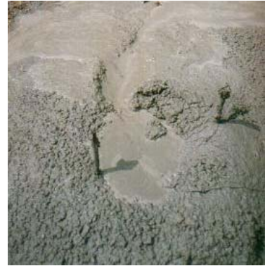
รูปที่ 5 การเข้มน้ำของคอนกรีตที่หัวเสาเข็ม
